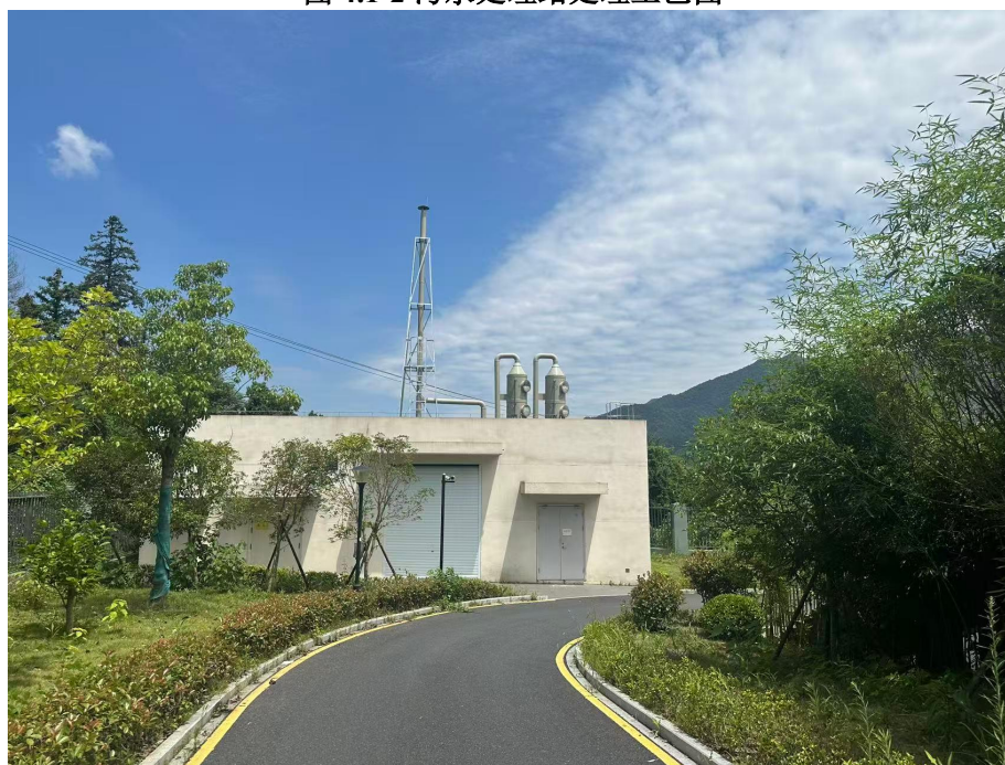
图 4.1-3 污水处理站环保设施及排气筒现场图
